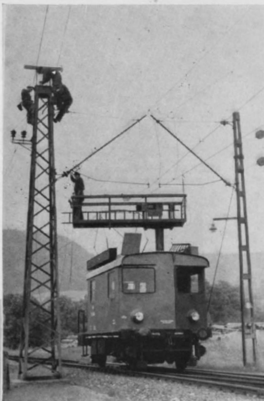
Abb. 12. Der Turmtriebwagen im Einsatz, zugleich die Rückansicht des Fahrzeugs.
